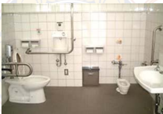
ภาพ 2.5 ห้องน้ำติดราวจับ เพื่อความปลอดภัยของผู้ใช้งาน
